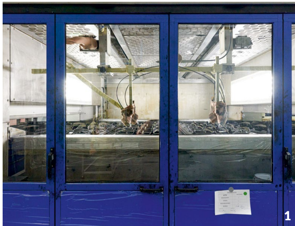
1: Die Beschichtung der Bauteile erfolgt auf zwei Flachbetтанlagen.
